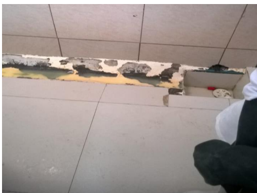
Fotografía 4A. Canaleta de salida donde se recoge el agua residual
