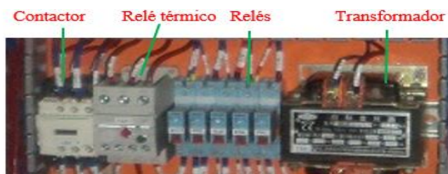
Figura 14-4: Armado Contactor, Relé térmico y transformador
