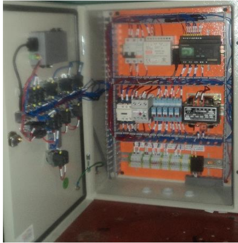
Figura 19-4: Parte interior del tablero de control Realizado por: Lema, César; Montoya, Luis; 2018
