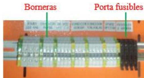
Figura 15-4: Armado borneras y porta fusibles
