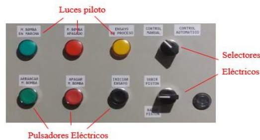
Figura 17-4: Armado de luces, pulsadores y selectores
