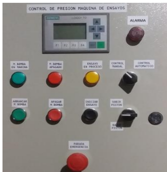
Figura 18-4: Parte frontal del tablero de control
