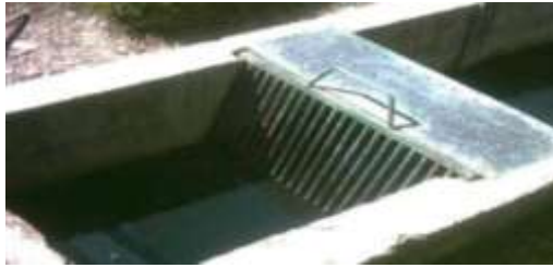
Figura 1-1 Rejillas de limpieza manual Fuente: (Anon., 2017)
