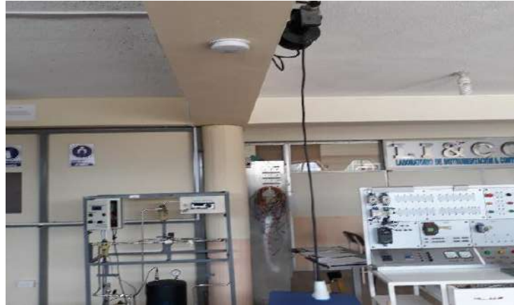
Figura 5-11: Detector de humo – laboratorio de instrumentación y control Realizado por: Jorge Encalada, 2018
