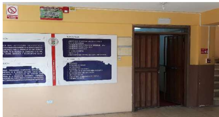
Figura 5-14: Instalación del sistema de alarma – planta baja E.I.M Realizado por: Jorge Encalada, 2018
