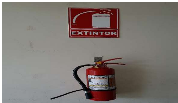
Figura 5-5: Colocación de extintor en el auditorio de la Facultad de Mecánica Realizado por: Jorge Encalada, 2018
