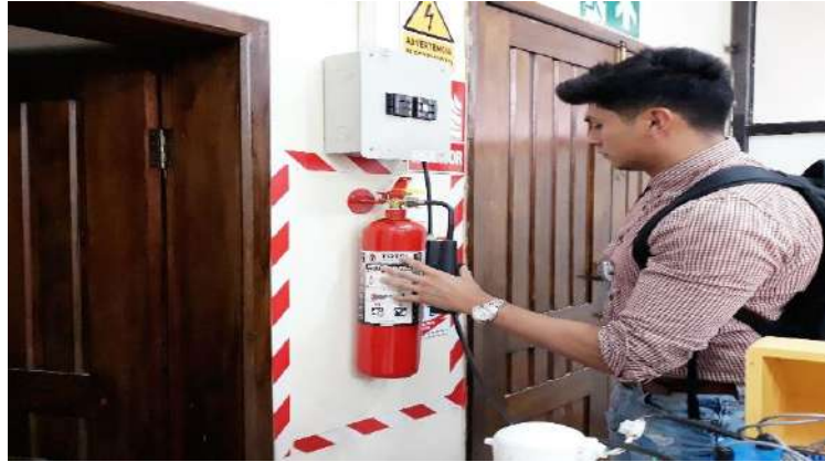
Figura 5-3: Colocación de los extintores portátiles en los diferentes laboratorios Realizado por: Jorge Encalada, 2018
