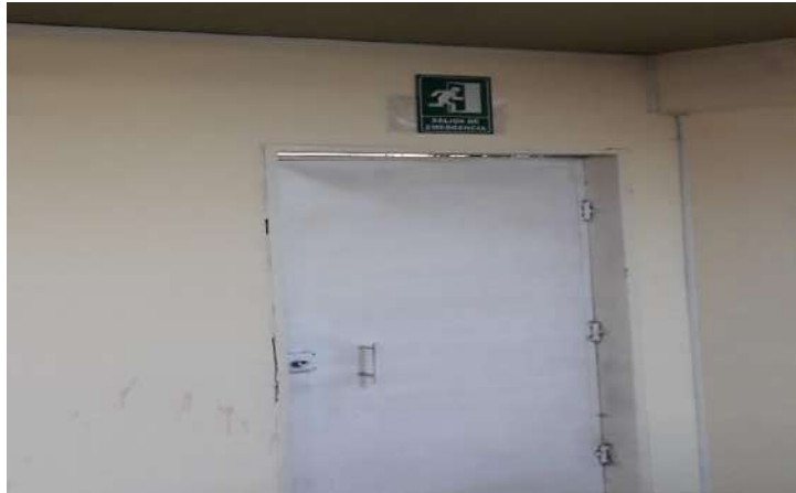
Figura 5-20: Señalética de evacuación en el auditorio de la FM Realizado por: Jorge Encalada, 2018
