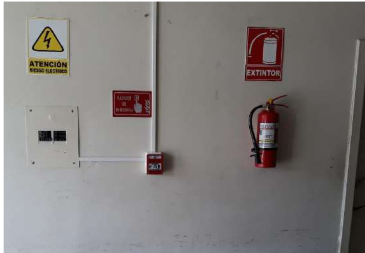
Figura 5-16: Instalación del sistema de alarma – auditorio FM Realizado por: Jorge Encalada, 2018
