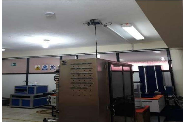
Figura 5-8: Detector de humo –laboratorio de mecánica de fluidos Realizado por: Jorge Encalada, 2018
