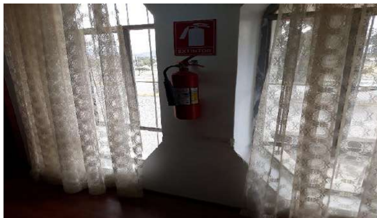
Figura 5-4: Ubicación de extintores portátiles en áreas administrativas Realizado por: Jorge Encalada, 2018
