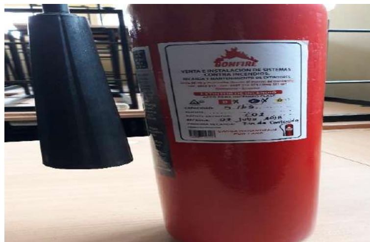
Figura 5-2: Extintor recargado con su etiqueta respectiva
