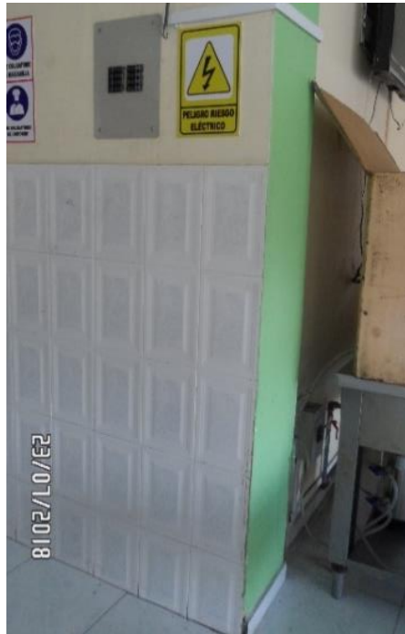
Figura 4-7: Señalética instalada sobre riesgo eléctrico en el laboratorio N° 4.
