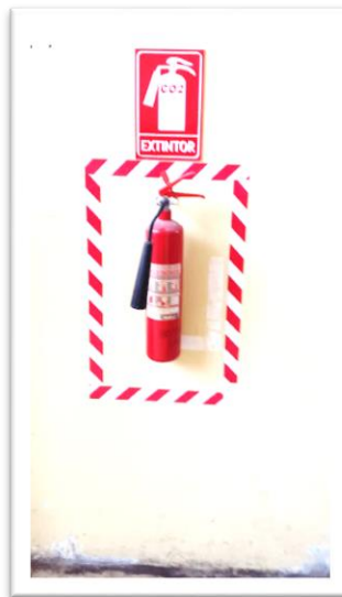
Figura 4-14: Implementación de señalética de extintores en el laboratorio N° 2.
