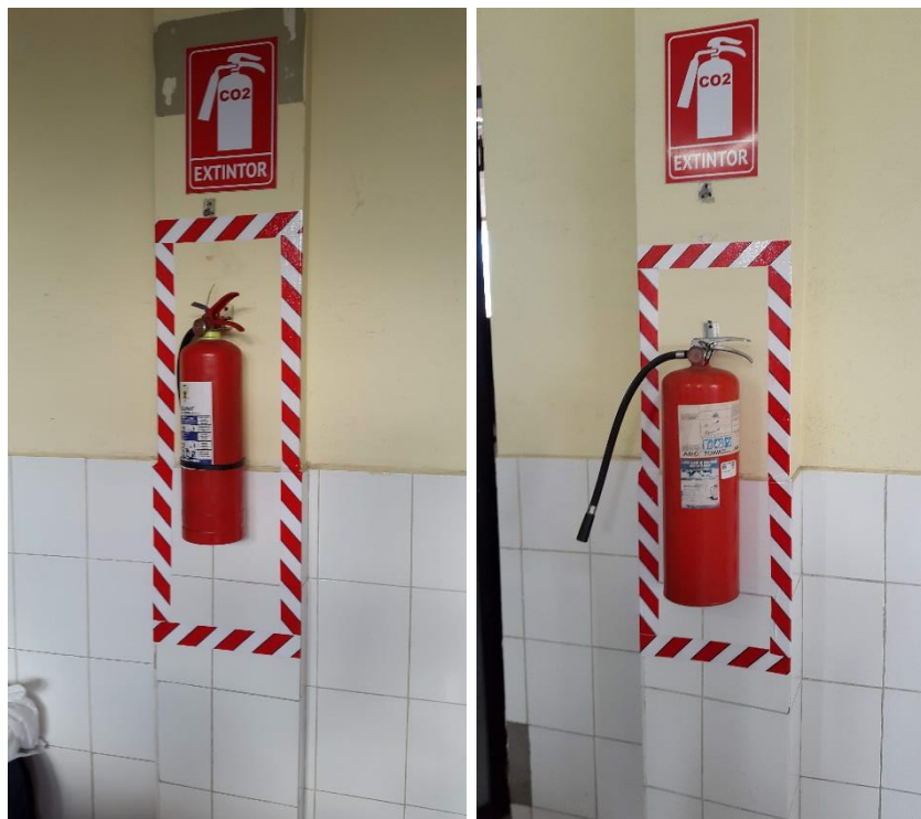
Figura 4-16: Implementación de señalética de extintores en el laboratorio de técnica dietética.
