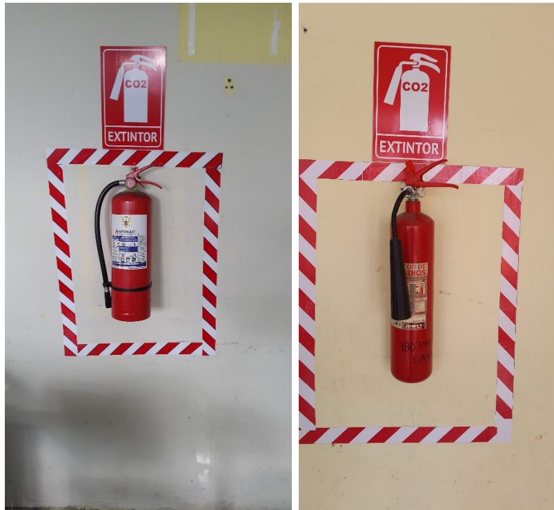
Figura 4-15: Implementación de señalética de extintores en el laboratorio N° 3.
