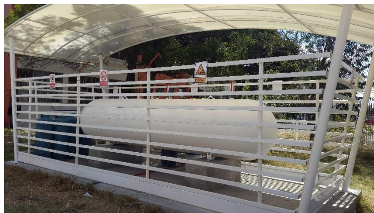
Figura 4-6: Señalética instalada en el área de almacenamiento de GLP
