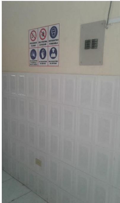
Figura 4-19: Señalética instalada de prohibición y acción obligatoria en la entrada al edificio N° 10.
