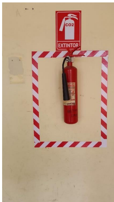
Figura 4-17: Implementación de señalética de extintores en la entrada al laboratorio de técnica dietética.
