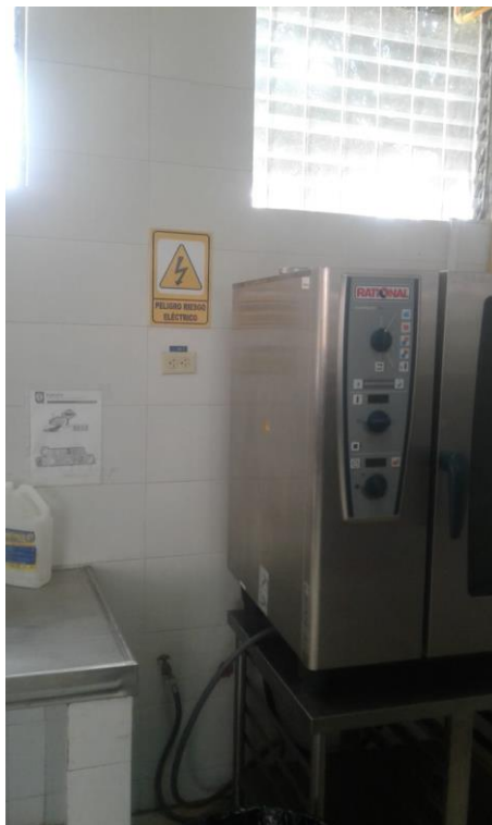
Figura 4-10: Señalética instalada sobre riesgo eléctrico en el laboratorio N° 2
