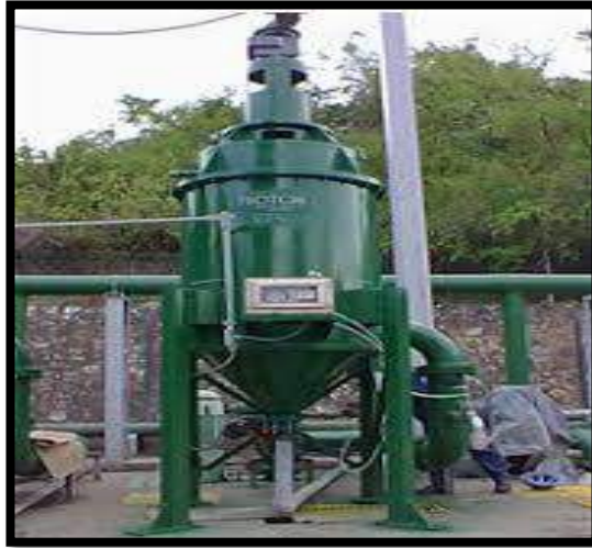
Figura 11-3: Equipo de filtración
