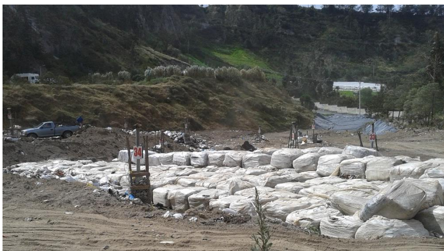
Fotografía 1-2 Relleno sanitario de la empresa EMMAIT-EP Realizado por: Alejandra Montaguano, 2018
