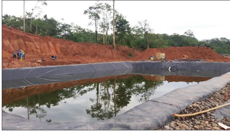
Fotografía 2-8: Piscina de almacenamiento secundario de la zona alta del Botadero.
