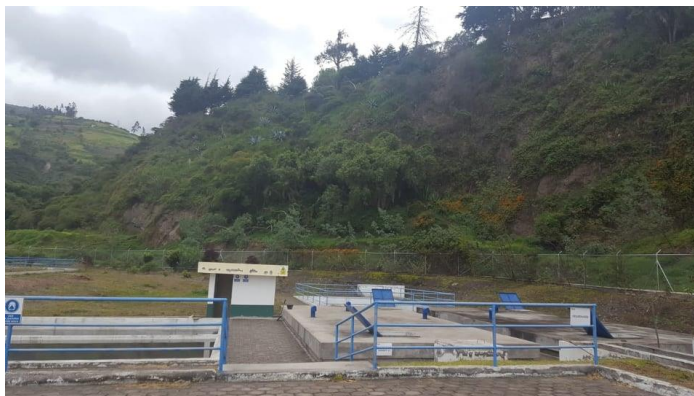
Figura 1-2: Zona de muestreo, Planta de Tratamiento de Aguas Residuales
