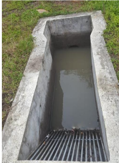
Figura 2-2: Toma de muestra en el Canal de acceso y rejillas
