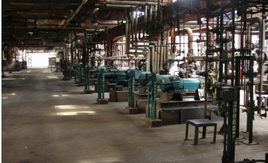
Figura 4.4: Patio de Bombas de la Unidad No Catalíticas II
