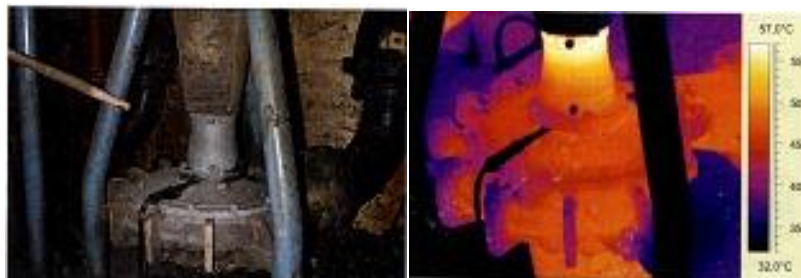
Figura 4.37: Fotografía e Imagen Térmica de una Bomba con Rodamientos Sospechosos
