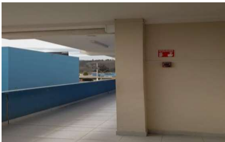
Figura 6-5: Pulsador de emergencia ubicado en Planta alta Modular 2 E.I.MKT Realizado por: Darwin Dávila.
