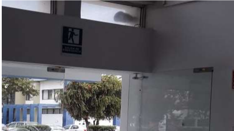
Figura 1-5: Sirena ubicada en el Modular 1 E.I.MKT
