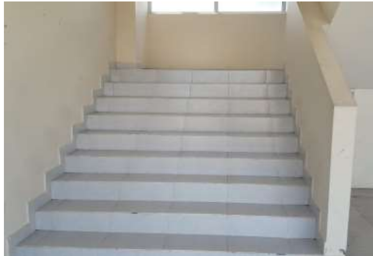
Figura 14-5: Graderío antes de colocación de cinta antideslizante Realizado por: Darwin Dávila.
