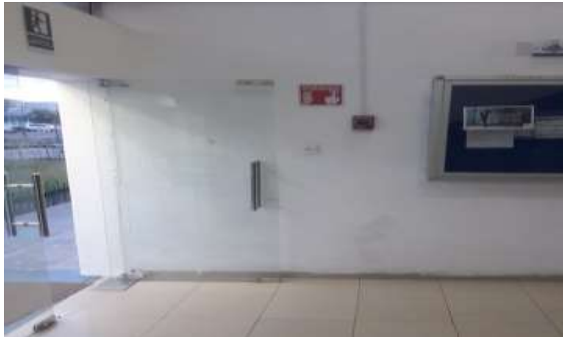
Figura 2-5: Pulsador de emergencia en Planta baja Modular 1 E.I.MKT
