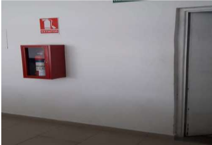
Figura 9-5: Implementación de gabinete para extintor planta alta Modular 1
