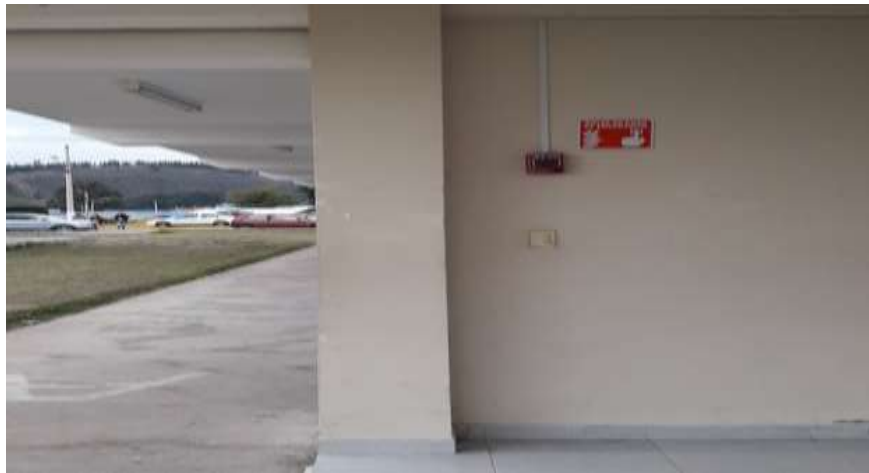
Figura 5-5: Pulsador de emergencia ubicado en Planta baja Modular 2 E.I.MKT Realizado por: Darwin Dávila.
