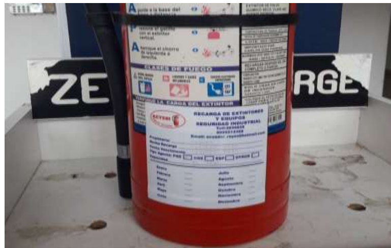
Figura 7-5: Inspección de extintores cumple para su operatividad.
