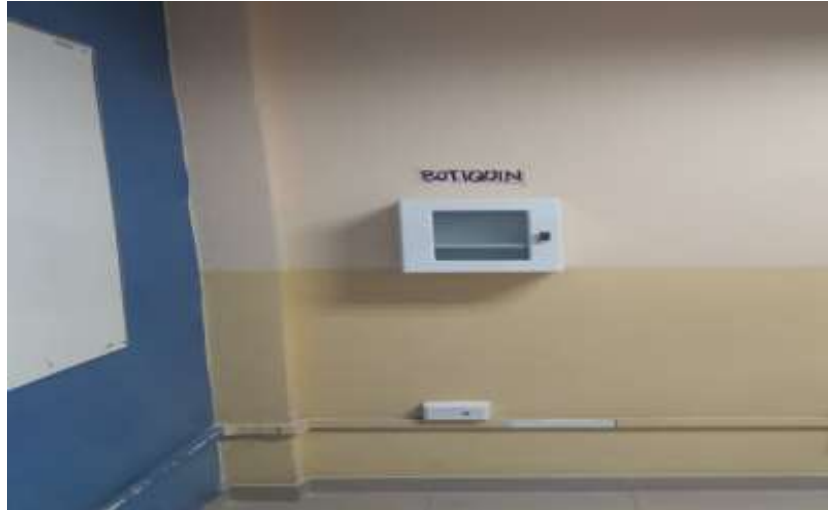
Figura 10-5: Botiquín antes de dotación de elementos primeros auxilios.
