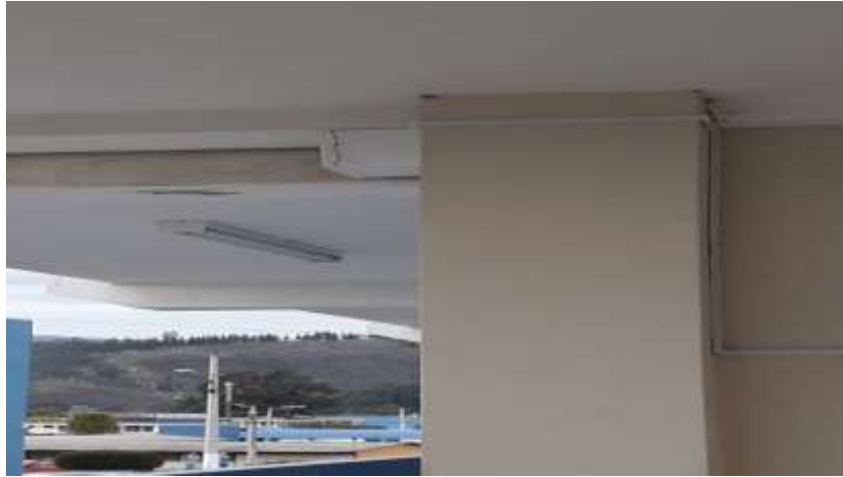
Figura 4-5: Sirena con protector ubicado en el Modular 2 E.I.MKT Realizado por: Darwin Dávila.
