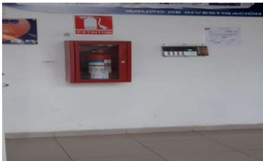
Figura 8-5: Implementación de gabinete para extintor planta baja Modular 1
