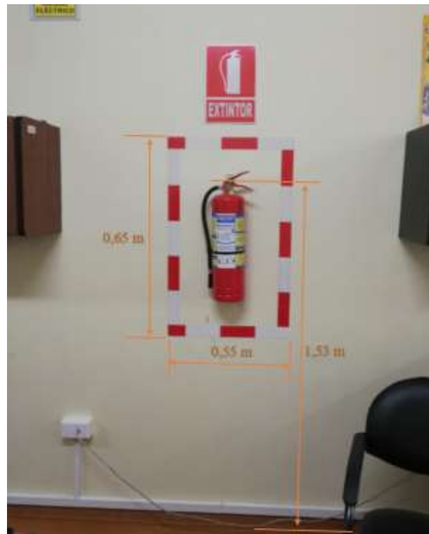
Figura 5-5: Señalización vertical según NFPA 10/Oficinas docentes/Bloque I. Realizado por. Emilio Ayala, 2019
