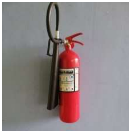
Figura 13-3: Extintores sin señalización/Planta alta/Edif.I.F Realizado por: Emilio Ayala, 2019
