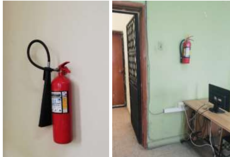
Figura 11-3: Extintores sin señalización/Planta alta/Edif.I.F Realizado por: Emilio Ayala, 2019
