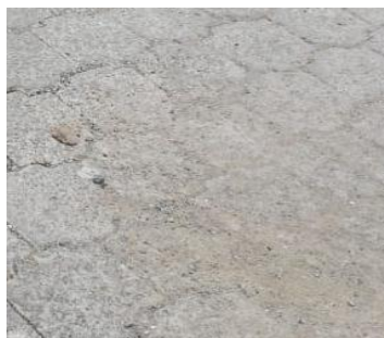
Foto 5.- Pérdida de arena
