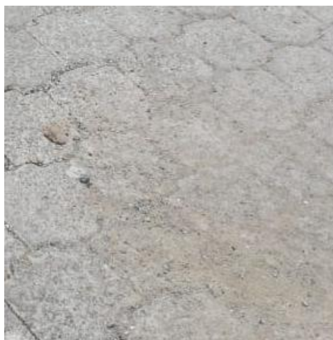
Ilustración 49 Pérdida de arena en la vía
