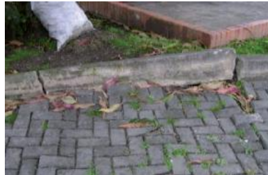
Foto 9 Fracturamiento de confinamientos externos
