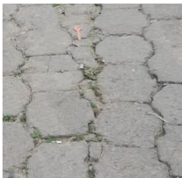
Foto 7 Desplazamiento de juntas
