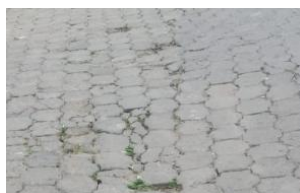
Foto 14 Vegetación en la calzada
