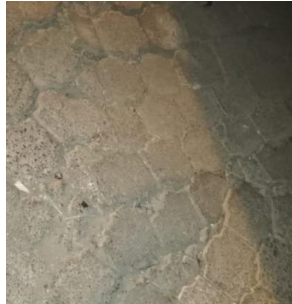
Foto 10 Fracturamiento de confinamientos internos
