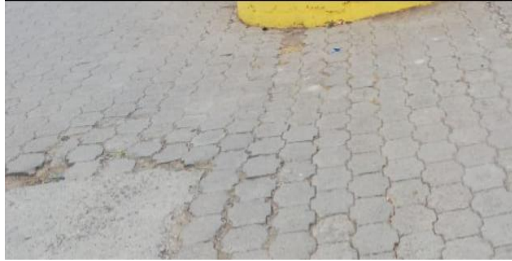
Ilustración 48 Depresión en la vía
