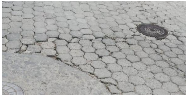
Ilustración 47 Abultamiento en la vía
