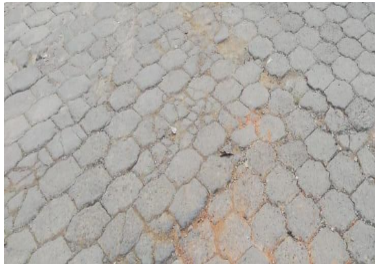
Ilustración 50 Fracturamiento en la vía
