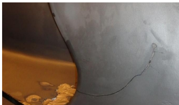
Figura 2-46: Fisura en álabe del rodete Francis HSF.
