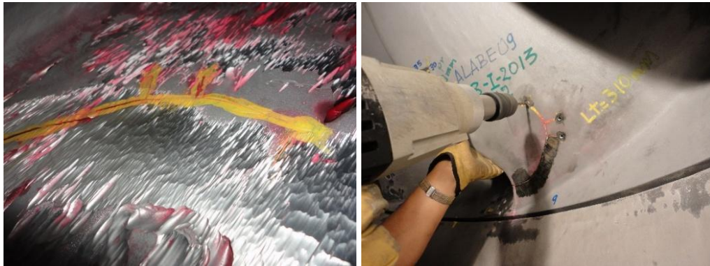
Figura 3-5 : Determinación de extensión de fisura y perforación álabes #09 U2
