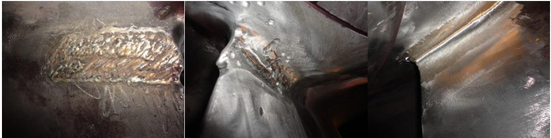
Figura 3-3 : Reparación fisura álabe #08.
