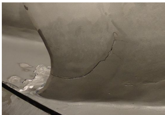
Figura 3-4: Fisura álabe #09 U2
