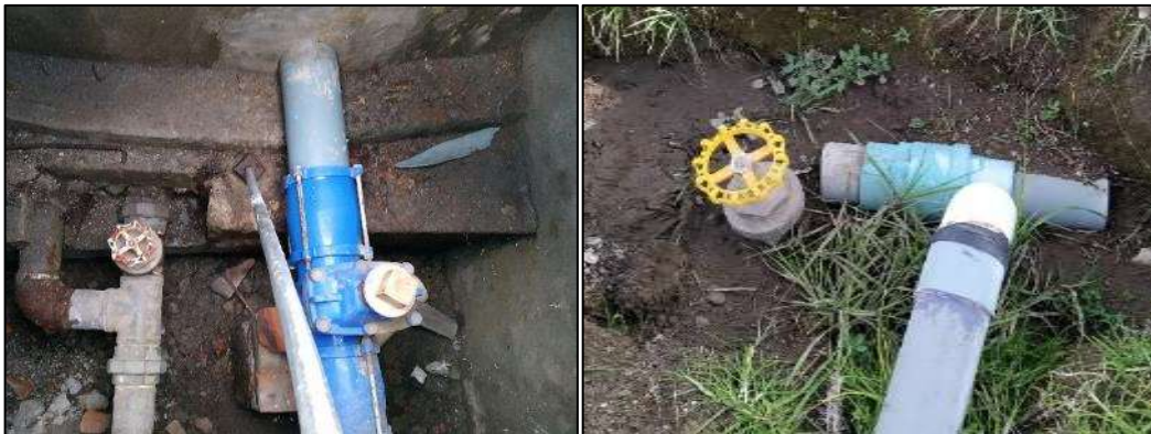
Figura 4-4: Válvulas a la salida de los tanques. Realizado por: Fiallos Avila Karen Lizbeth, 2019.
