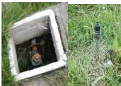
Figura 7-3: Válvulas en la Línea en conjunto. Fuente Fiallos Avila Karen Lizbeth, 2019.
