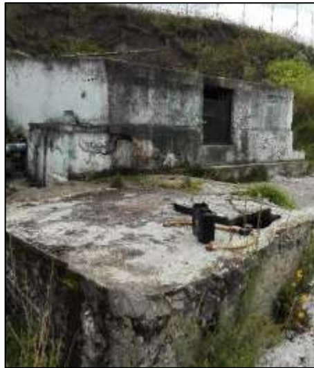
Figura 1-3: Tanque Antiguo. Fuente Shobolpamba. Realizado por: Fiallos Avila Karen Lizbeth, 2019.
