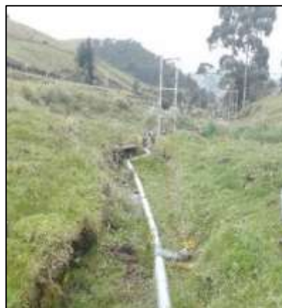
Figura 5-3: Válvula de vaciado y cruce de río. Realizado por: Fiallos Avila Karen Lizbeth, 2019.
