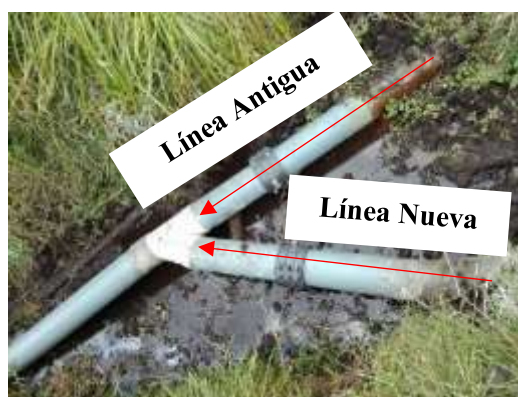
Figura 6-3: Punto de unión de las tuberías “Yee” Fuente Fiallos Avila Karen Lizbeth, 2019.
