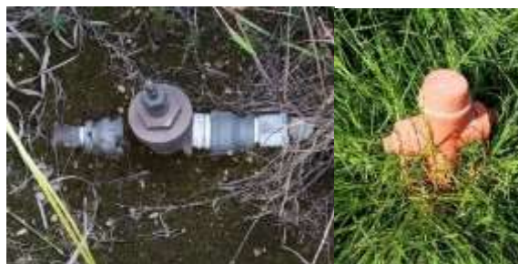
Figura 31-3: Válvula de regulación y boca de incendios Realizado por: Fiallos Avila Karen Lizbeth, 2019.
