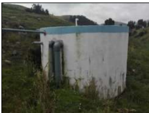
Figura 3-3: Tanque línea Nueva.
