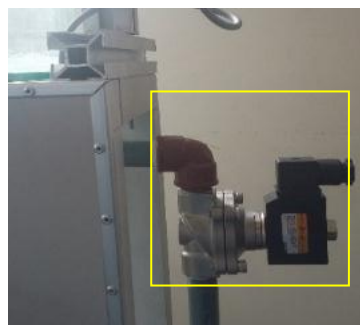
Figura. 15-3: Montaje de la electroválvula. Fuente:(Autores)
