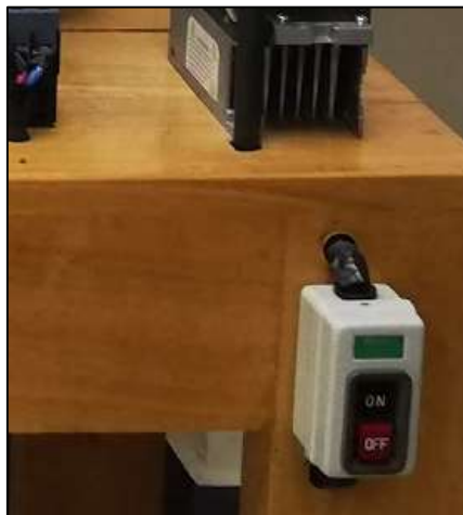
Figura 4-3: Ausencia de un breaker de protección. Fuente: (Autores, 2019).
