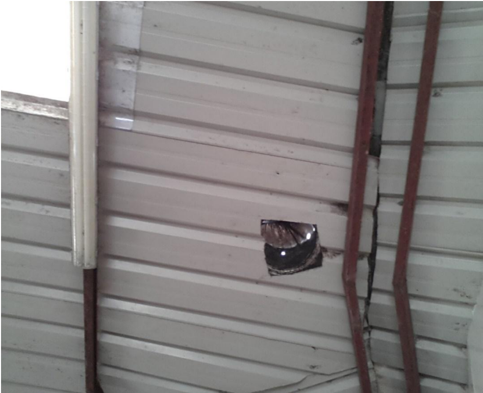
Figura 48-11: Área de procesamiento, cuarto de prensado del queso Realizado por: Miguel Romero. 2018
