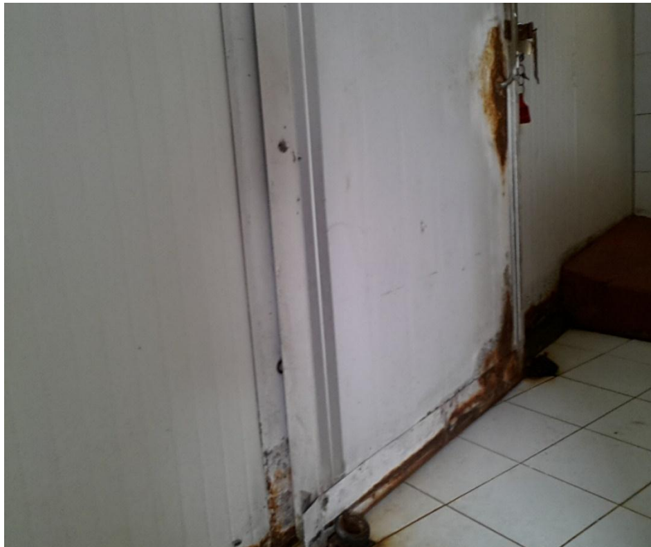
Figura 64-11: Puerta del cuarto frío Realizado por: Miguel Romero. 2018
