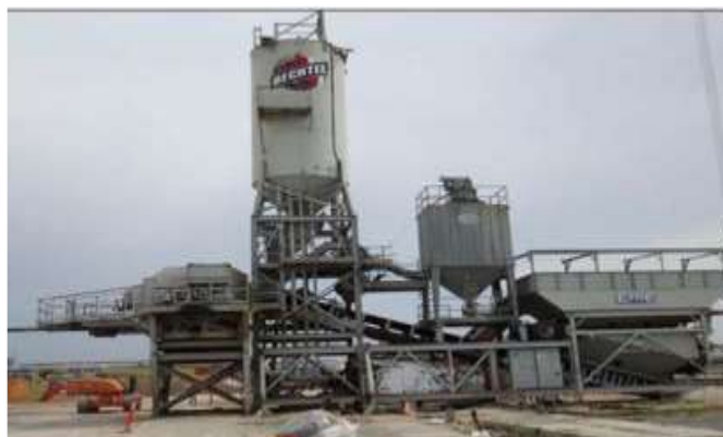
Figura 8: Planta de Hormigón 150 m 3 /hora.
