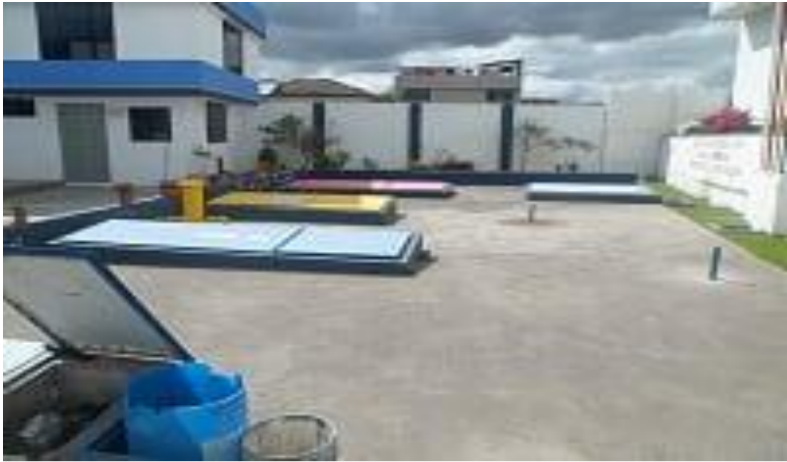
TANQUES DE ABASTECIMIENTO DE COMBUSTIBLE SUPER-EXTRA Y DIESEL
