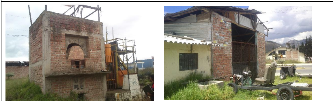
Infraestructura anticuada considerada un riesgo para los estudiantes
