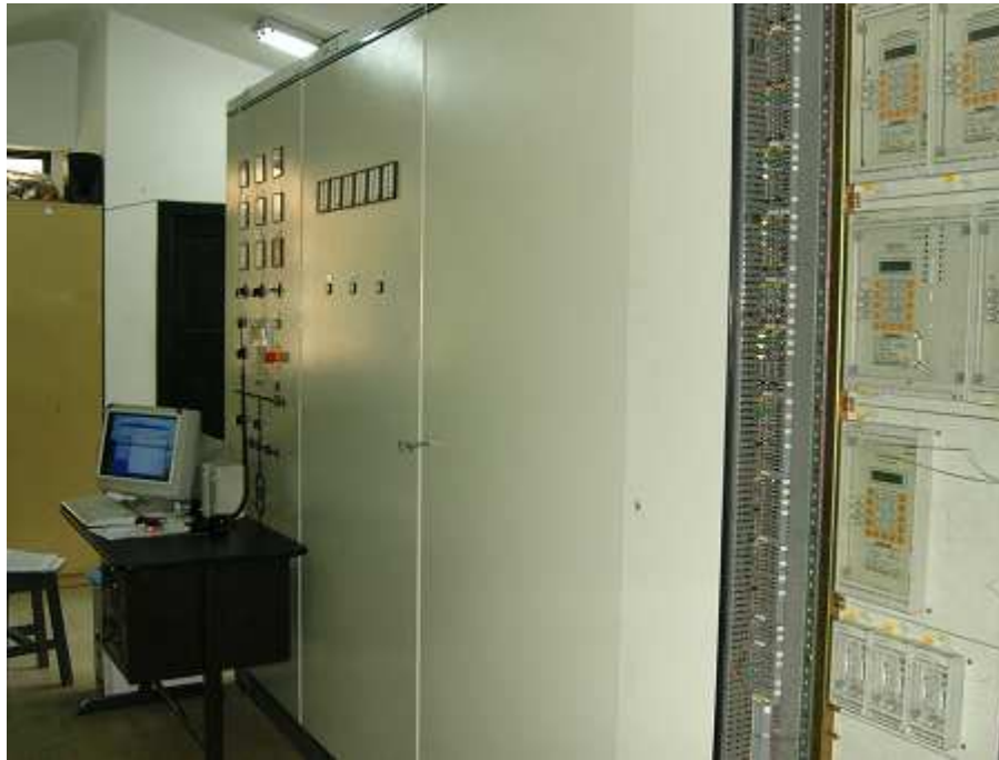
Fig. 4: Cuarto de control central río Blanco
