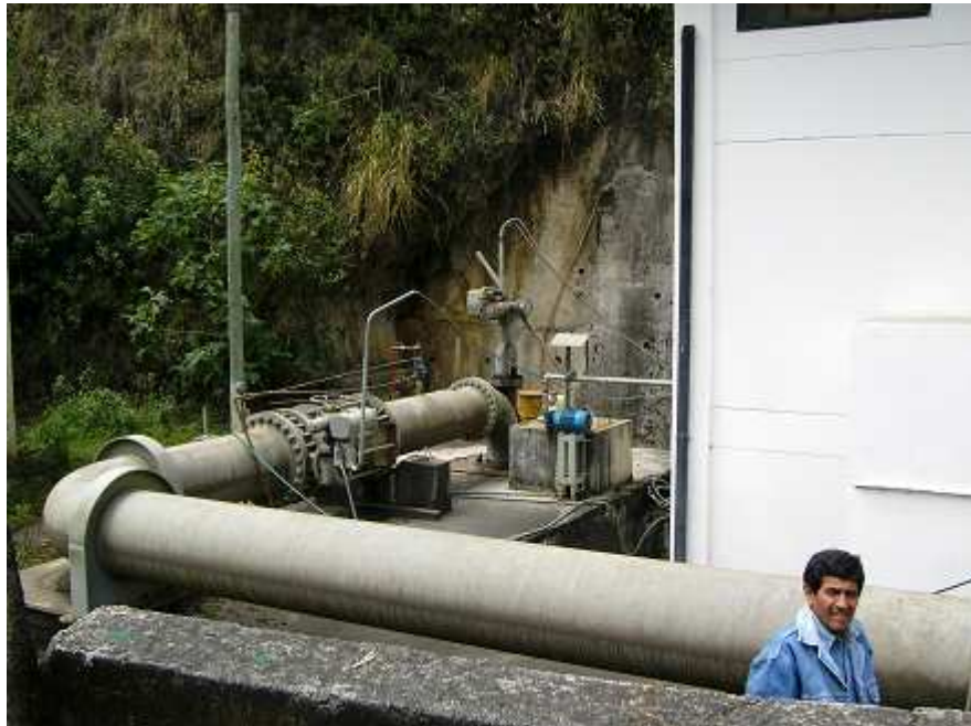
Fig. 5: Tubería de presión central río Blanco
