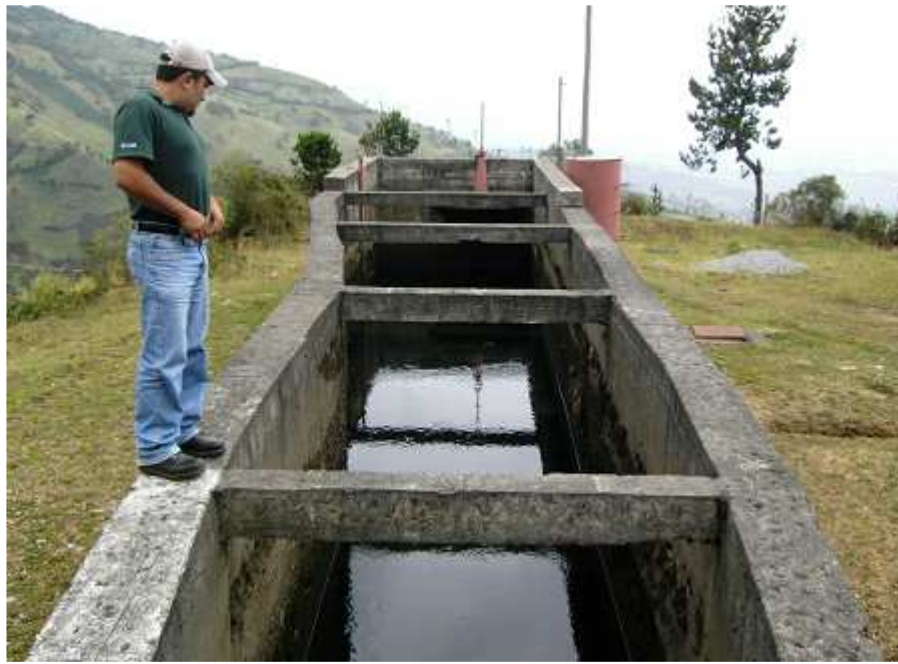
Fig. 8: Vista general tanque presión río Blanco
