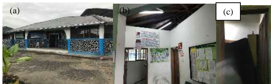
Figura 3-3: Unidad Educativa Bilingüe Amauta Ñanpi. (b) Inspección y (c) Bodega del coliseo. Realizado por: Allauca, Paola; 2019
