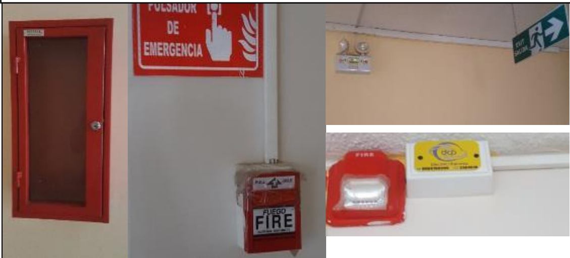
Figura 19-3: Hall de ingreso planta baja, ascensor, sistema de detección y equipo contra incendios
