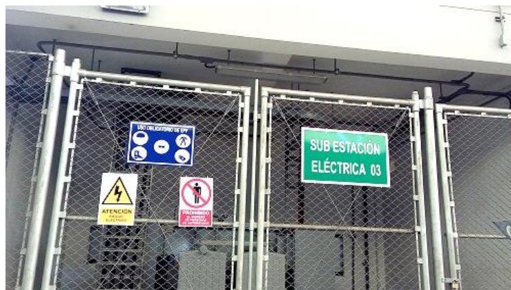
Figura 16-4: Estación de energía eléctrica propuesta Fuente: Propia
