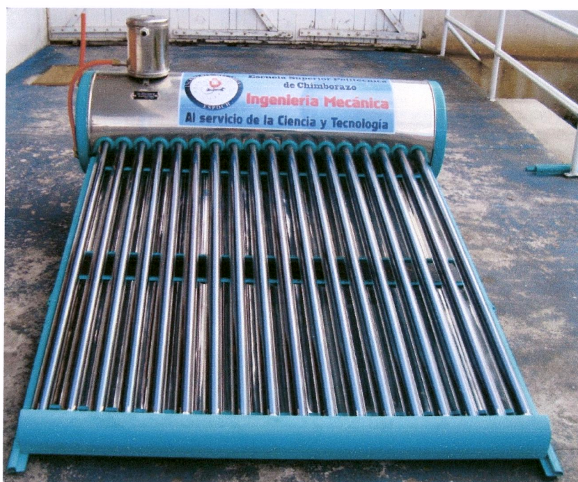
Fig. 5.6: Colector solar armado completamente con sus respectivas conexiones
