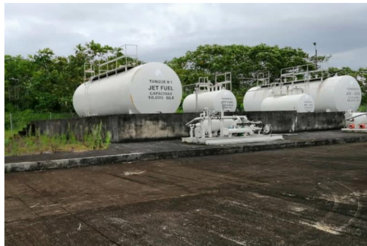
Figura 6-3: estación de almacenamiento y despacho de combustible
