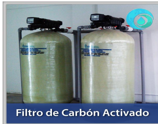
Figura 14-3: Filtro de carbón activado
