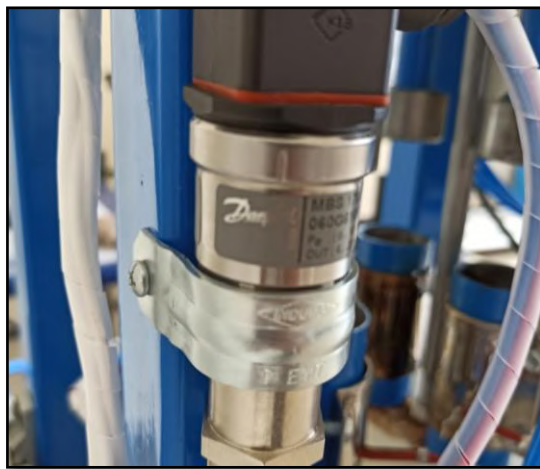
Figura 6-4. Instalación del transmisor de presión
