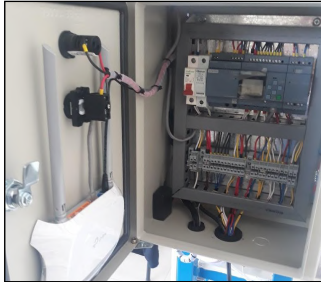
Figura 15-4. Tablero de control máquina briquetadora
