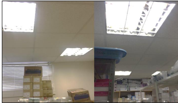
Figura 3-3: Sistema de ventilación e iluminación de la farmacia.
