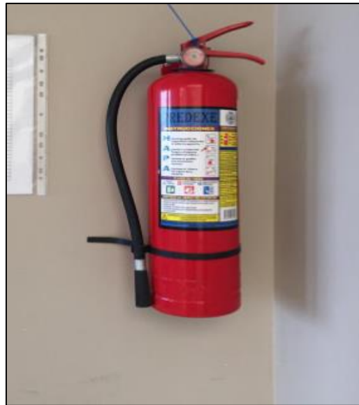
Figura 6-3: Extintor de incendios del servicio de farmacia.
