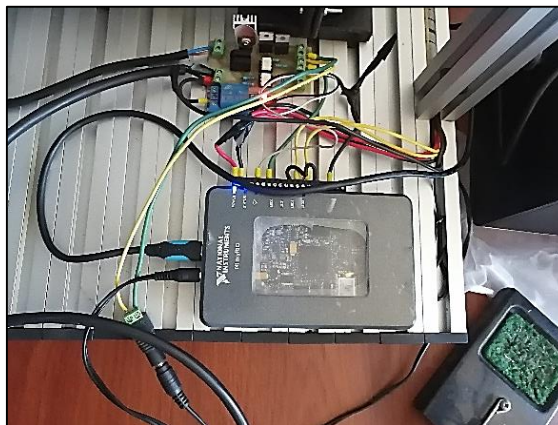
Figura 7-3: Montaje de la tarjeta NI myRIO-1900 en la estructura Al
