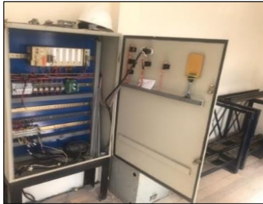
Figura 211-3: Tablero de control de la compuerta
