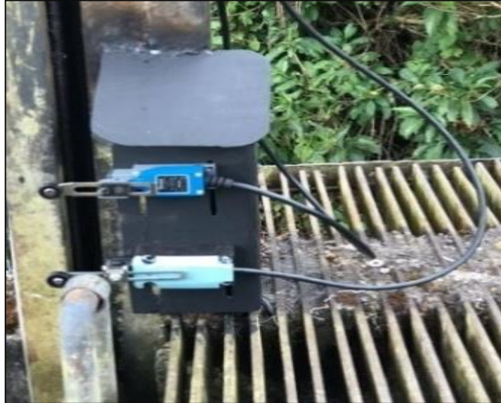
Figura 20-3: Calibración y fijación de sensores
