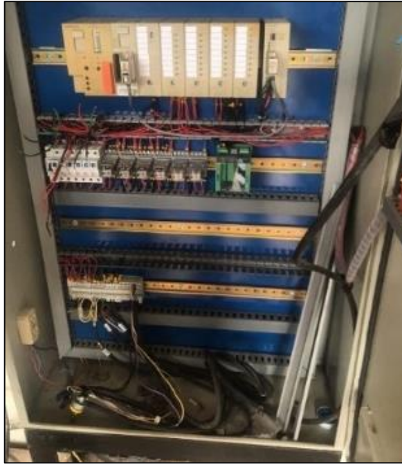
Figura 3-3: Cableado del tablero de control antiguo
