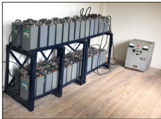
Figura 5-3: Banco de baterías
