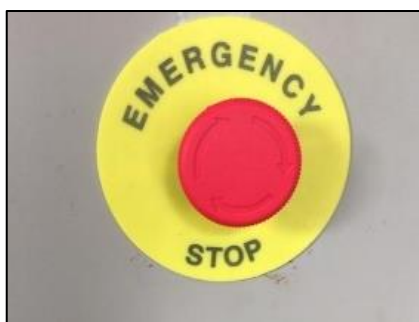
Figura 68-3: Paro de emergencia
