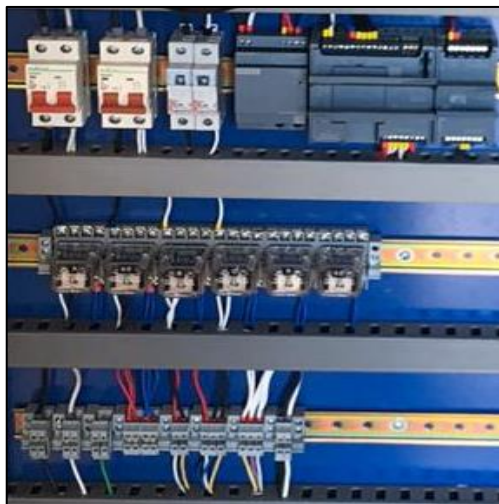
Figura 23-3: Bornes de conexión en tablero
