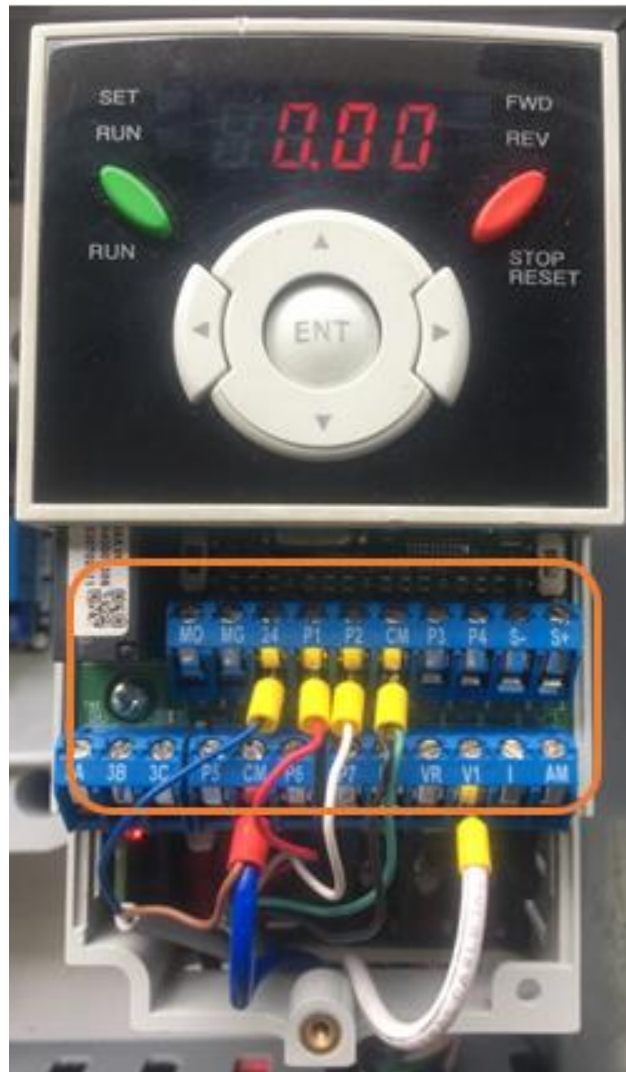
Figura 9-2: Terminales de conexión variador de frecuencia Realizado por: ROMERO, Patricio
