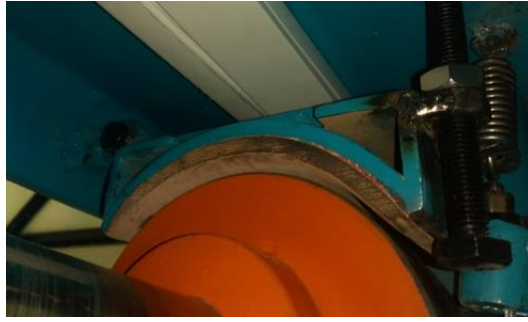
Figura 20-3. Soporte ajustable y muelle mecánico sustituidos.
