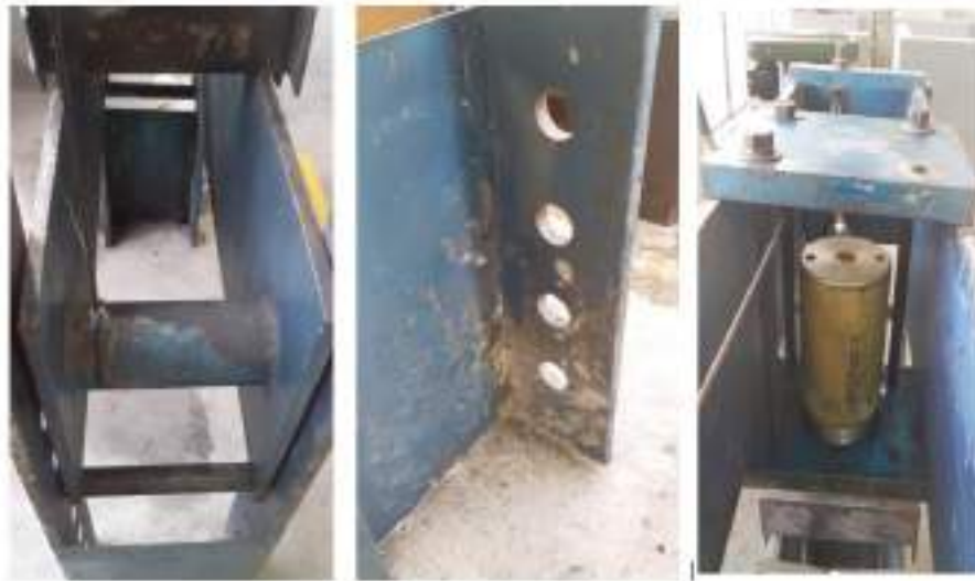
Figura 48-3. Zona interna afectada por la corrosión generalizada.
