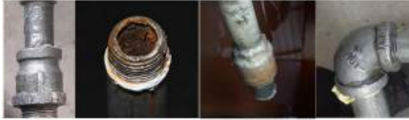
Figura 40-3. Daños en la tubería y accesorios.
