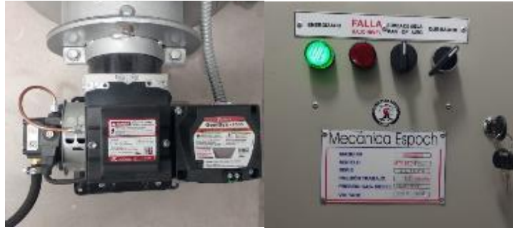
Figura 2-4: Colocación del quemador a diésel e instalación eléctrica de la caja de control
