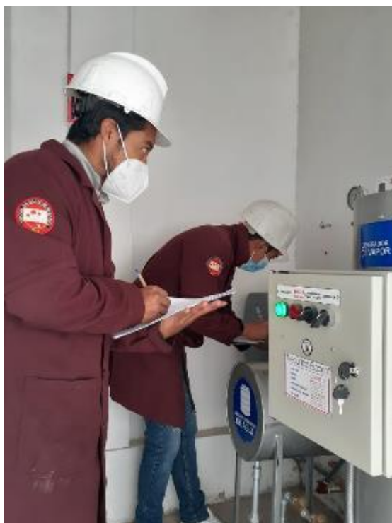
Figura 9-4: Toma de parámetros del generador de vapor
