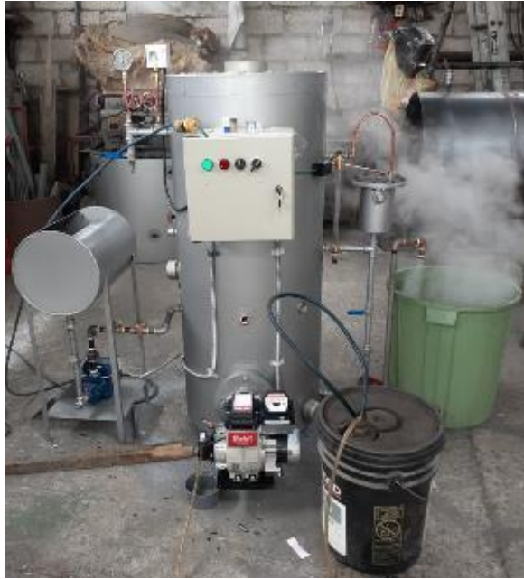
Figura 63-3: Pruebas de funcionamiento del generador de vapor.
