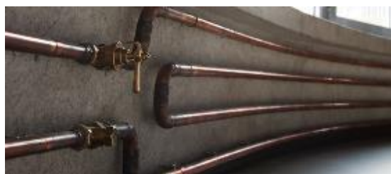
Figura 12-2: Tubería de Cobre
