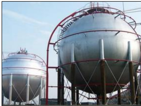
Figura 5 – 2. Tanque a alta presión
