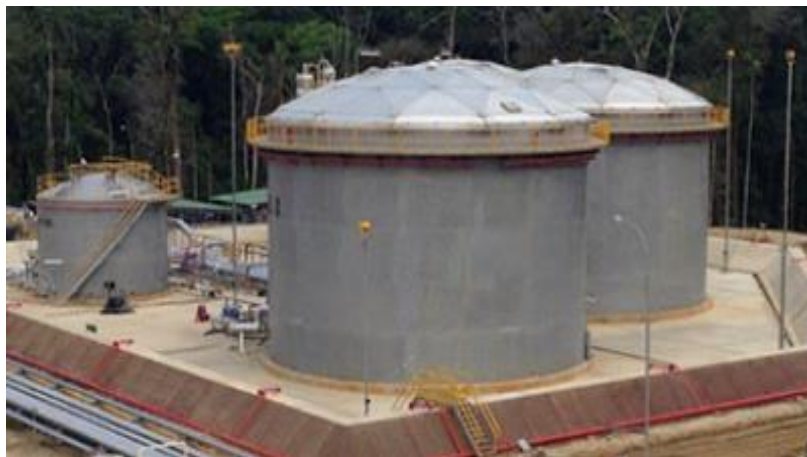
Figura 2 – 2. Tanque de almacenamiento de crudo región amazónica
