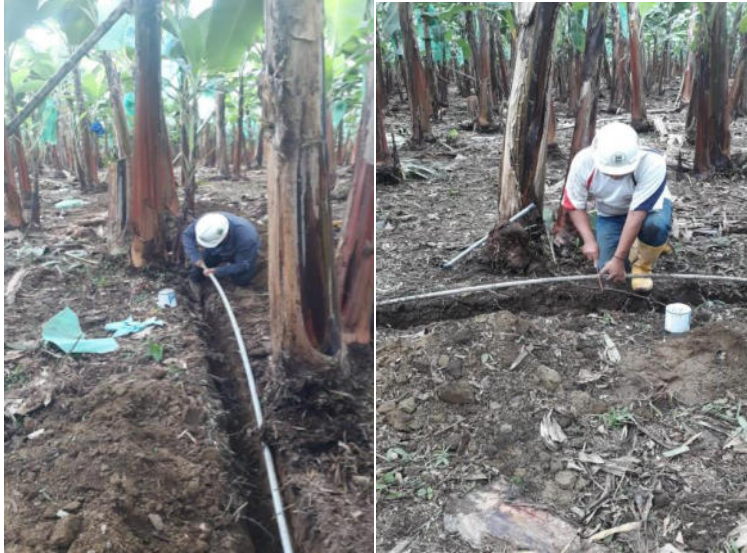
Figura 27-3: Instalación Realizado por: Brito, J., & Tene, M. 2020
