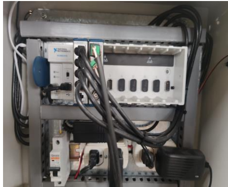
Figura 62-3: Cabina del sistema. Realizado por: Taday J., Panchi A., 2021.
