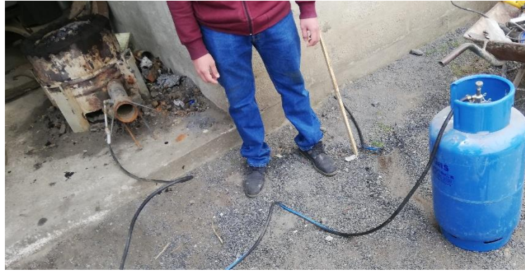
Figura 72-3: Conexión de GLP.
