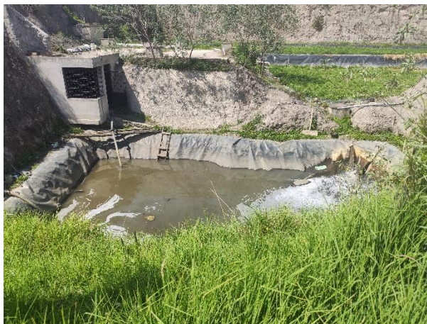
Figura 1-2. Tanque donde llegan las aguas servidas prefiltradas
