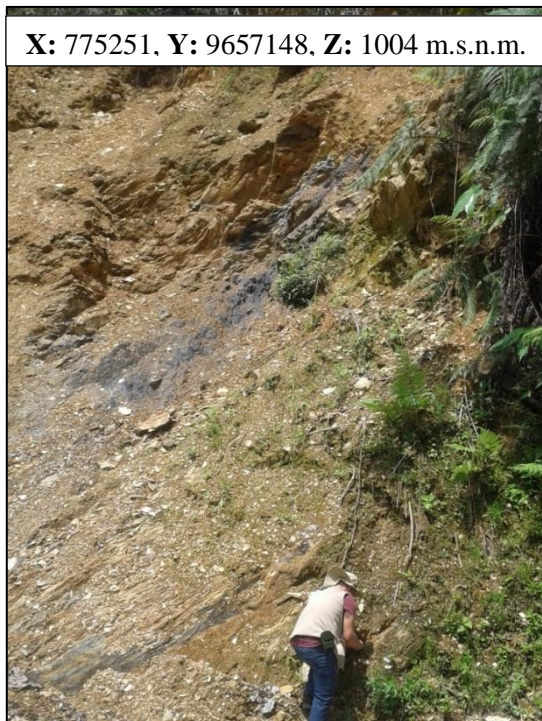
Figura 11-A. Talud de estratos de Lutita muy meteorizada, intercalación de Pizarras y Filitas alteradas. (GL31).
