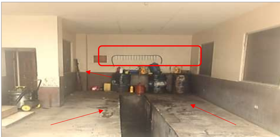
Figura 6-3: Falta de señalización del área de almacenamiento de aceite residual
