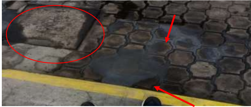
Figura 4-3: Contaminación de conductos de alcantarillado
