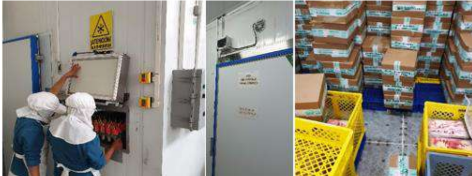
Figura 15-3. Túnel y cámara de frío para almacenamiento. Realizado por: (Autor, 2020)
