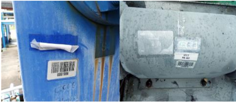
Figura 12-3: Etiquetas identificativas de los equipos deterioradas. Fuente: Calle Fernando, 2020
