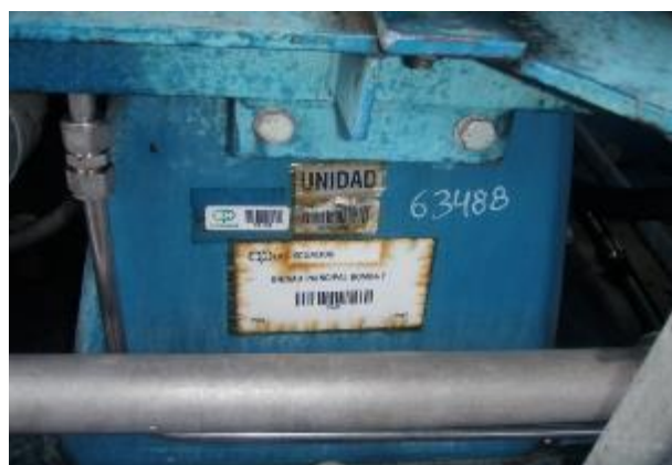
Figura 19-3: Equipo con presencia de suciedad.
