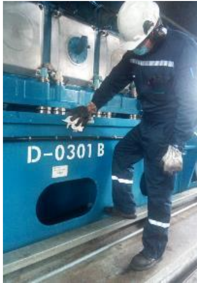
Figura 11-4: Operador realizando la limpieza de los equipos. Fuente: Calle Fernando, 2020
