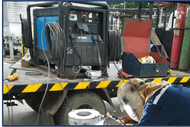
Figura 6-3: Moto soldadora en sitio de trabajo operativa
