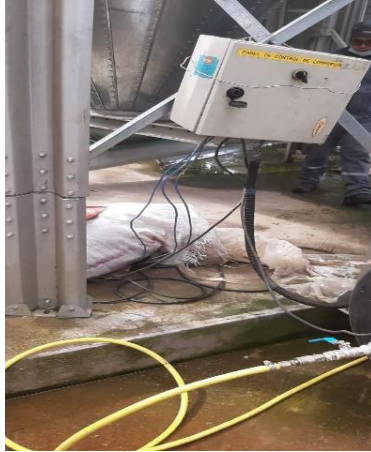
Figura 5-3. Cableado eléctrico desordenado y sin protección
