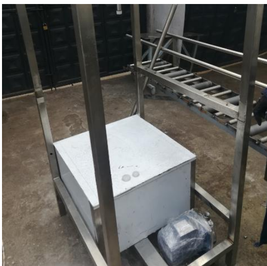
Figura 28-3: Reservorio y bomba. Realizado por: Iván Silva,2021
