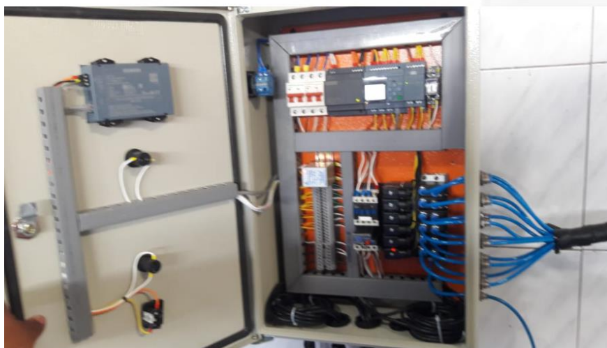
Figura 39-3: Tablero de control encendido. Realizado por: Iván Silva,2021
