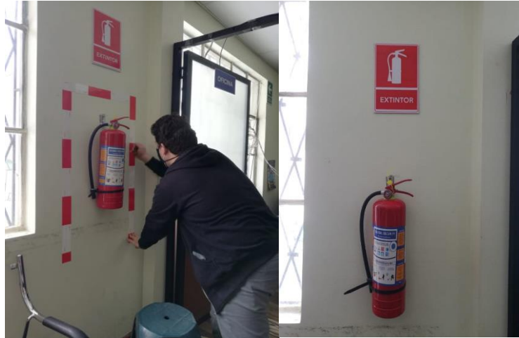
Figura 3-4: Señalética de equipo de lucha contra incendios
