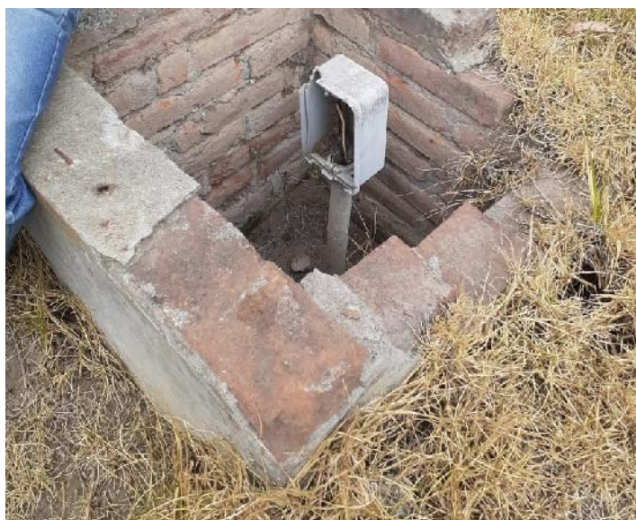
Figura 18-3. Protección catódica 2, obra civil en mal estado (Quebrada de Guaslán).
