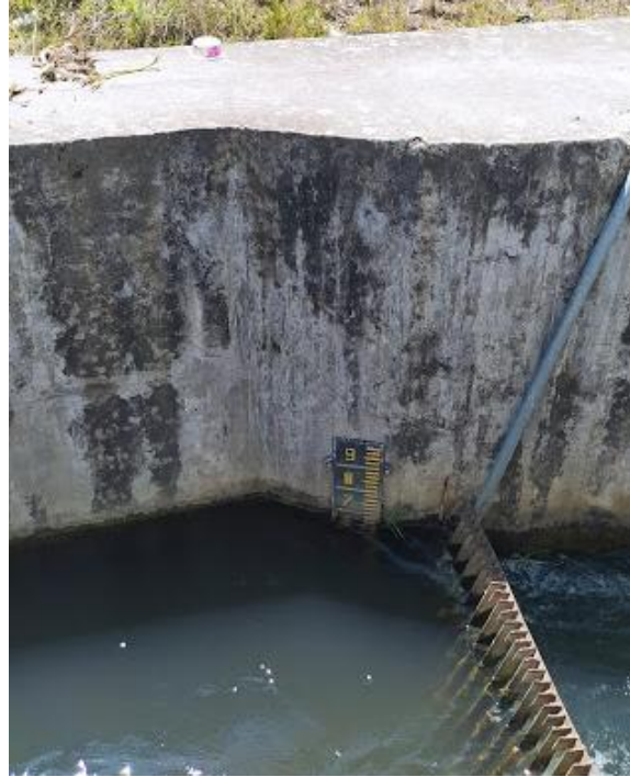
Figura 14-3. Caudal de ingreso a la tubería TB11
