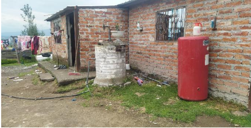
Figura 37-5. Válvula de aire 1 reservorio 67B en el interior de una propiedad
