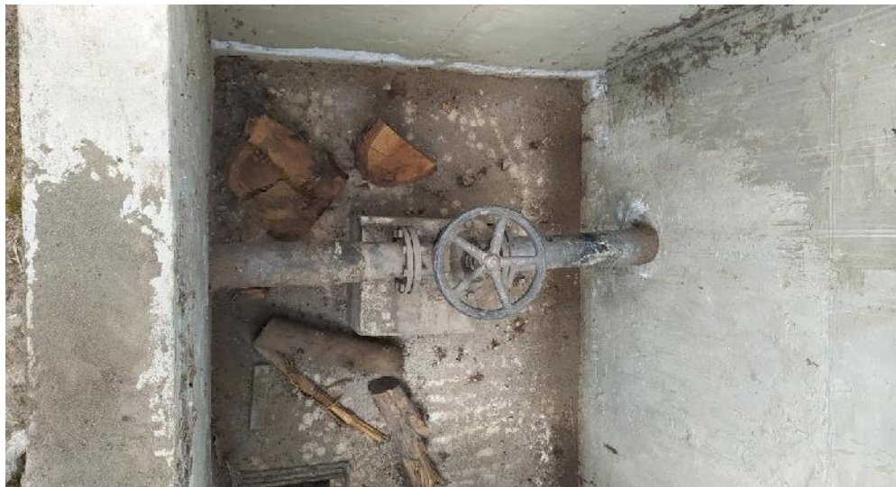
Figura 27-3. Válvula de desfogue del ramal hacia el reservorio 51
