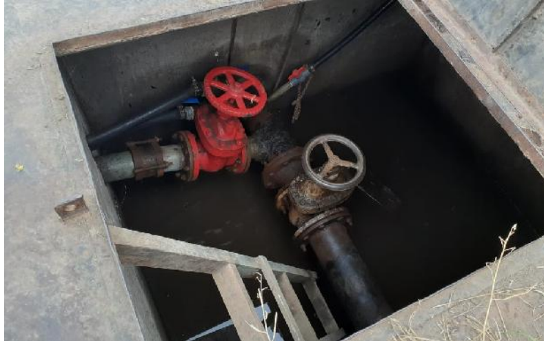
Figura 19-3. Válvula de desfogue 5 con adecuación para mini proyectos San Jacinto y Romero.
