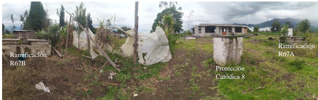
Figura 25-3. Fin de la tubería TB11 referencia protección catódica 8.
