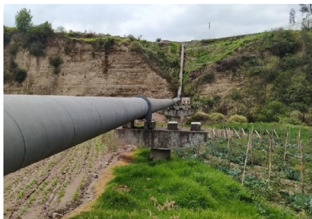
Figura 15-3. Paso elevado tubería TB11, quebrada de Guaslán
