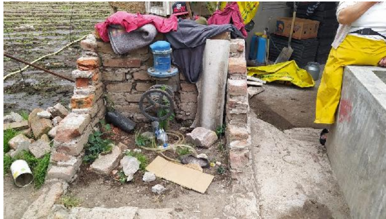
Figura 21-3. Válvula de aire 2 junto a vivienda, comunidad San Antonio
