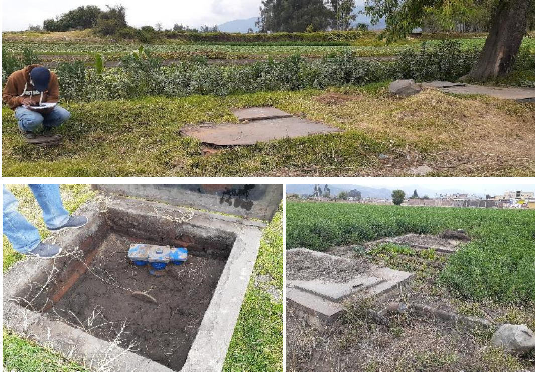
Figura 36-5. Malas condiciones de los accesorios por falta de mantenimiento
