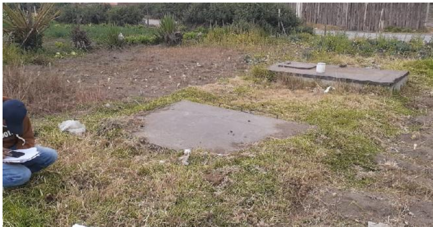
Figura 20-3. Cámara de válvula de desfogue 16 cubiertas de tierra (San Clemente)
